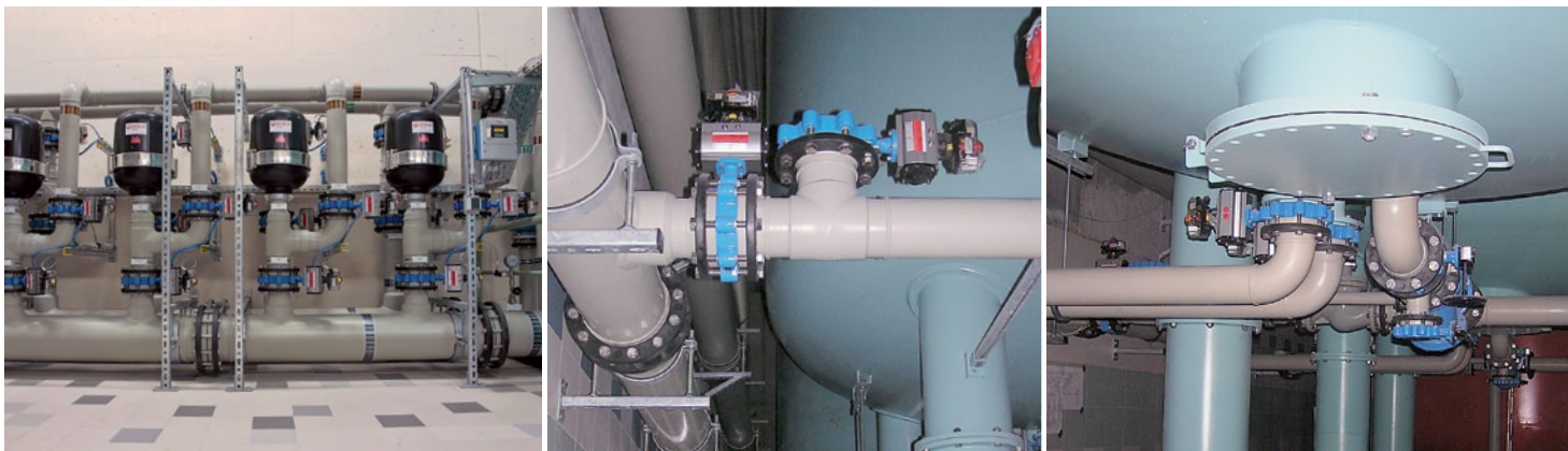
De izquierda a derecha: Planta de filtrado del agua de la red; desvío - bypass; conducto de salida y regeneración
