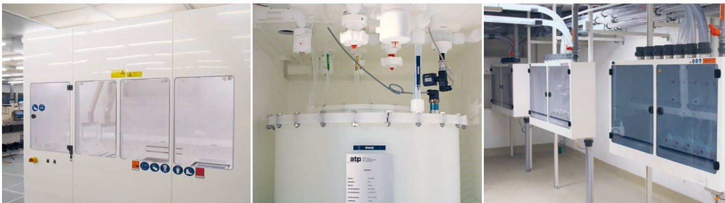
De izq. a dch.: planta automática de proceso húmedo; vista interior de sistema de suministro de productos químicos; sistemas de distribución para conexiones de equipos
